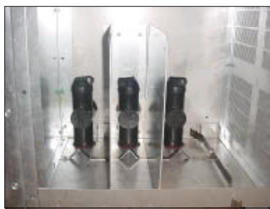
Figura 8: Segregación y compartimentación metálica de las barras
